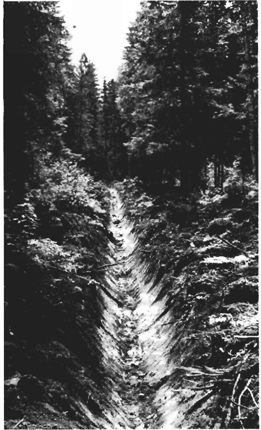
Kuva 2. Ohutturpeiselle savimaasoistumalle varhain keväällä kaivettu metsäoja, kaivuvaikeusluokka 2. Jos samaa ojaa kaivettaisiin poutakesän jälkeen kaivuvaikeusluokka saataisi olla 3 tai 4.
