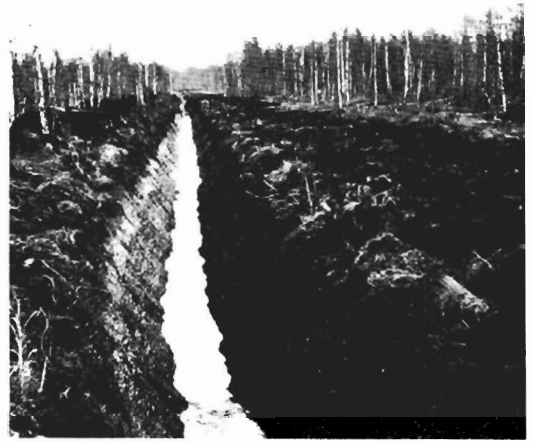
Kuva 2. Kookkaan sarkaojan varteen on ojamaavalli tasaamalla saatu aikaan piennartasanne. Työssä on kuitenkin menetelty sikäli väärin, ettei kaikkia ojaimaita ole nostettu ajoväylän puoleiselle reunalle, jolloin olisi saatu käyttöön enemmän maata ja siten rakennettua parempi piennartasanne.
