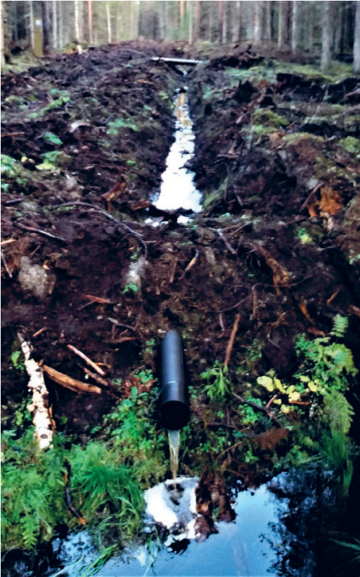
Kuva 3. Suovaluma-alueelta tulevaa valuntaa ja vedenlaatua voidaan seurata mittapadoilta, kuten kuvan putkipadolta, jonka päästä voidaan mitata valuntaa esimerkiksi astialla ja kellottamalla sekä ottaa vesinäytteitä, joiden ainepitoisuudet analysoidaan laboratoriossa. Valuntamittauksia voidaan myös automatisoida. Putkipatoa käytetään myös käytännön suometsätaloudessa ns. virtaamansäätörakenteena, jossa yläpuolisen ojaverkoston vesien virtaamaa voidaan hillitä sekä sen tyhjentymistä hidastaa ylivirtaamaaikoina. Kuva: Sakari Sarkkola.
