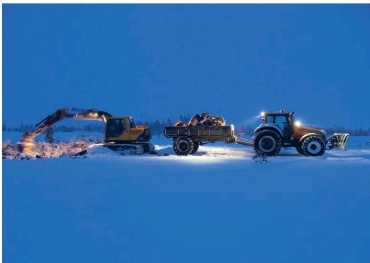
Kuva 1. Rahkasammalbiomassan talvikorjuuta Kurikan Pallonevalla tammikuussa 2011. Korjuu ja lähikuljetus voidaan talvella roudan aikaan toteuttaa yleisesti käytössä olevalla konekalustolla, kaivinkoneella ja traktorilla (Kuva: Niko Silvan).
